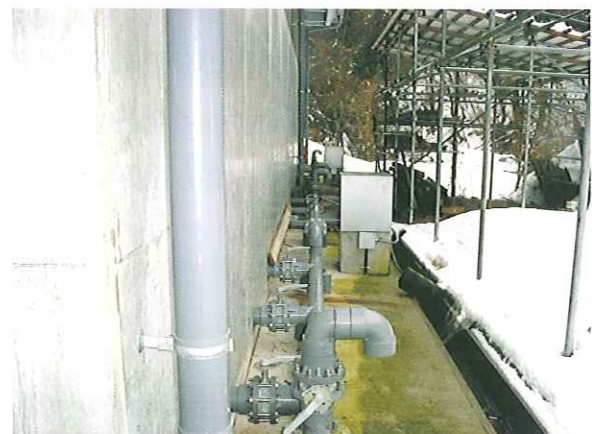
写真8：通気装置外部・ブローと配管
