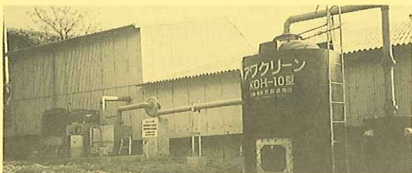
写真3：発泡消臭装置 発酵槽からでる臭気を完全に除去
